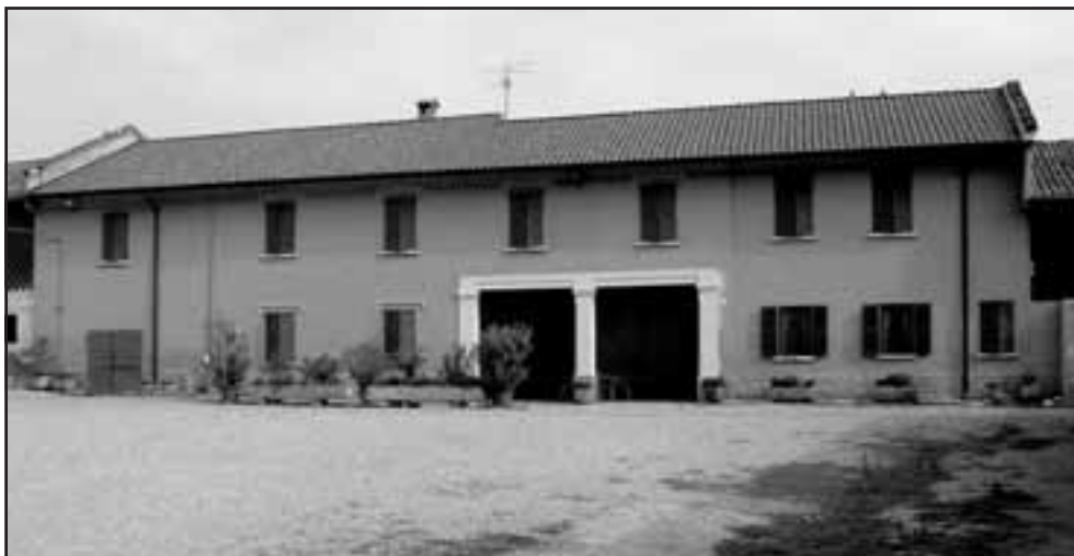
Casa padronale alla Strepata, colpita e danneggiata da un proiettile inesplosivo, sparato dalla contraerea di Melegnanello.
